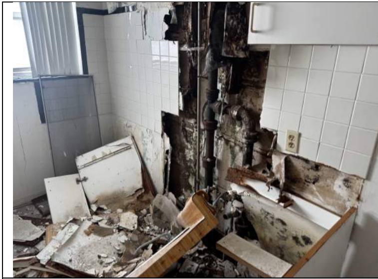
Stud wall damage
