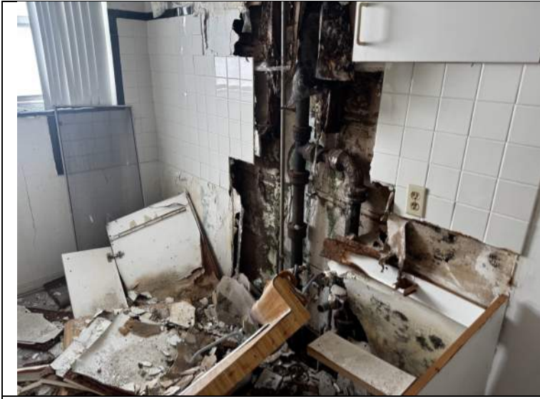
Stud wall damage
